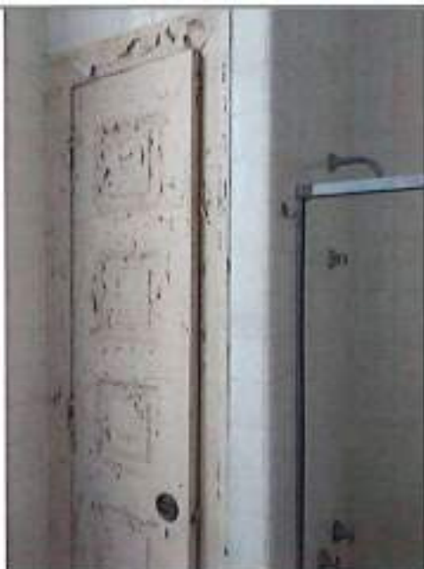
Foto 5: Puerta del armario, marco de la puerta y marco, en todo el edificio,
