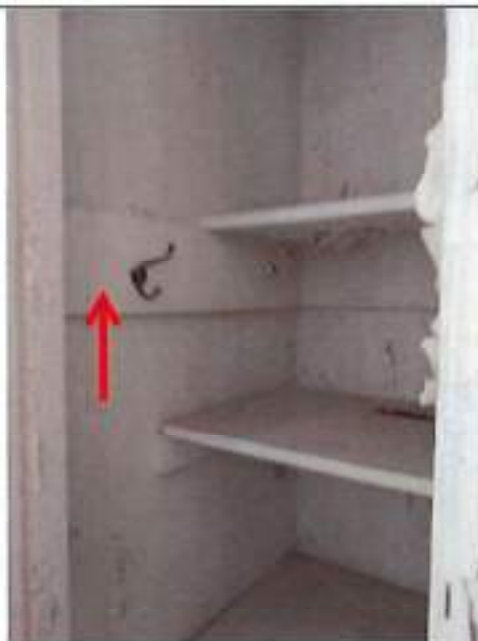
Foto 6: Estantes de armario y soporte de estantes en todo el edificio.
