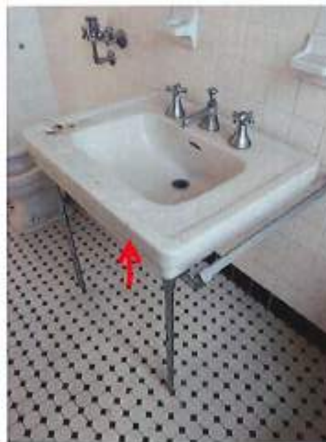
Foto 8: Lavabo de cerámica blanca, en todos los baños del edificio.
